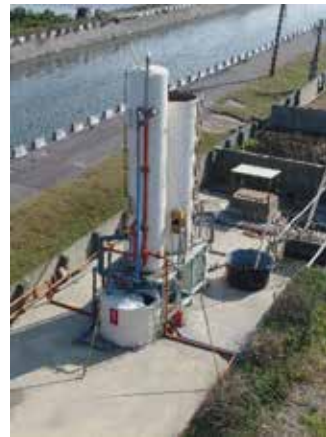
(b) 水洗沼氣純化塔
