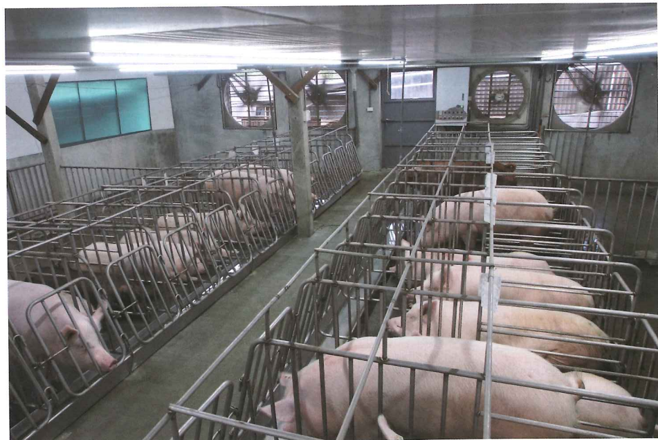
整修竣工後的新合興牧場，豬舍環境整潔明亮，雖豬隻實際飼養量僅1,500多頭，但因新一代厭氧發酵技術，讓沼氣發電效率大增，每年售電收入將近百萬元。
