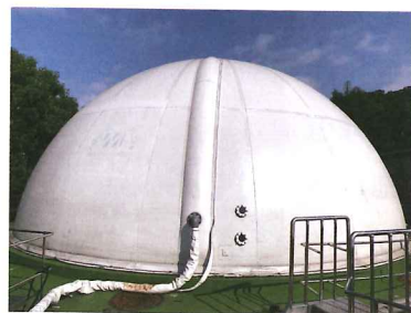
上圖為厭氧發酵槽細部， 下圖為沉砂與排砂裝置。
