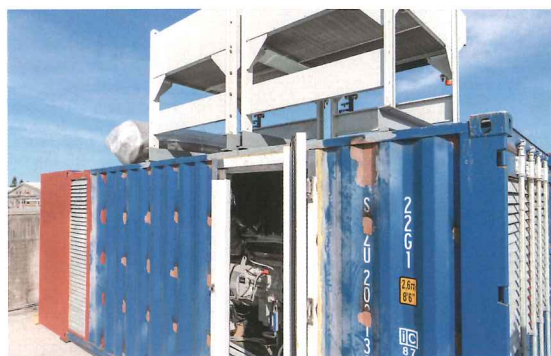
集美牧場裡的沼氣發電系統。根據畜牧場豬隻飼養量，估計每日可生產約1萬8,000度的電能。
