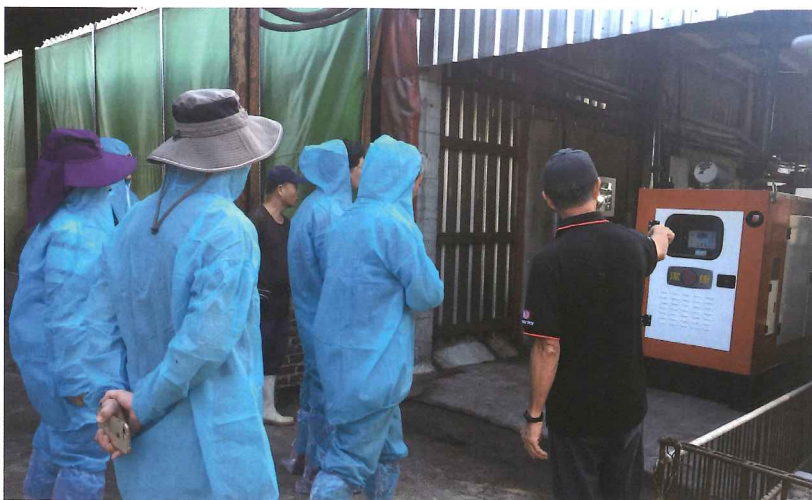
沼氣發電應評估沼氣產能，再配置適宜的發電機組，以達到良好的發電運轉率。
