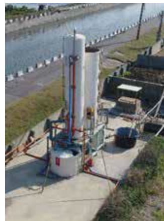
(b) 水洗沼氣純化塔
