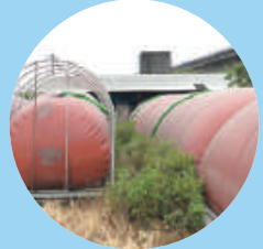
集氣及儲氣設備
