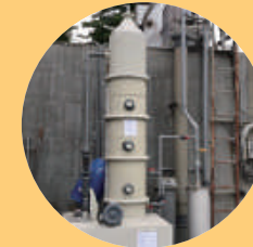
沼氣脫硫設備
